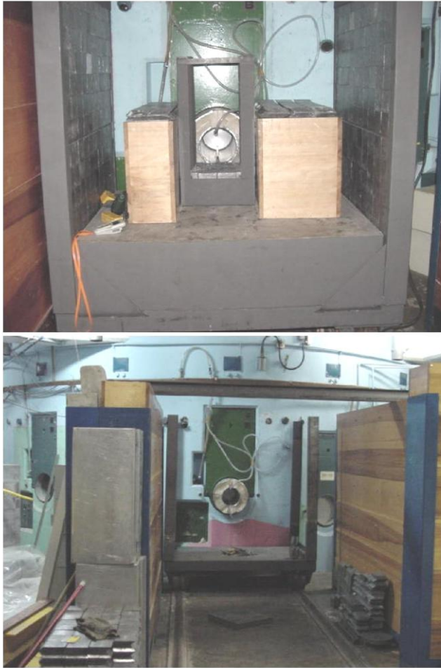
Figura 15 – Reestruturação do canal BH-8 do equipamento de radiografia com nêutrons. Detalhe da saída do feixe de nêutrons e as blindagens laterais de chumbo e de parafina borada e concreto.
